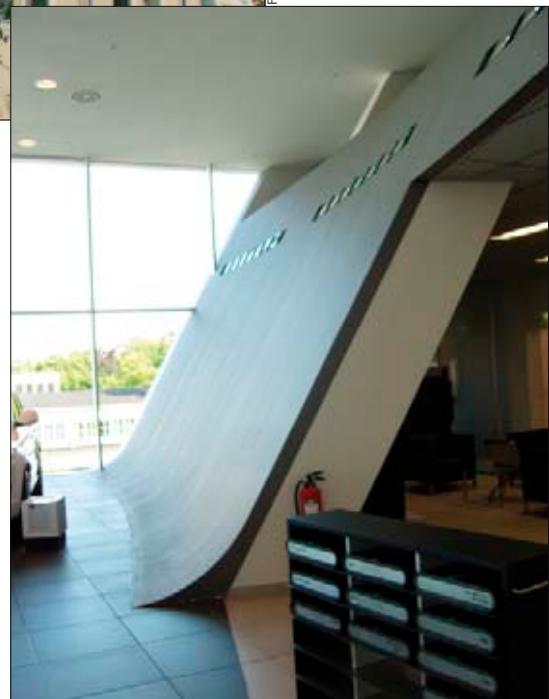
Die CI-Umsetzung bei der Steilkurve ist besonders heikel, insbesondere der Anschluss vom Boden zur Wand. Eine einheitliche Lösung gibt es nicht.
